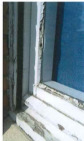
Foto 4. Desperfecte marc de fusta
