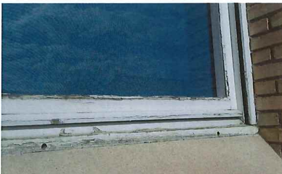
Foto 11. Desperfecte marc de fusta
