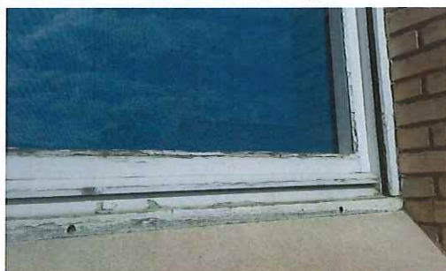
Foto 5. Desperfecte marc de fusta
