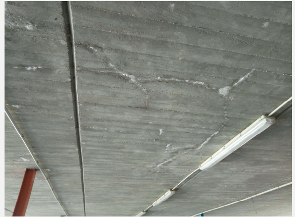
Foto 7. Eflorescència sota la coberta
