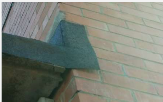
Foto 4. Làmina despegada en la unió amb l'edifici principal
