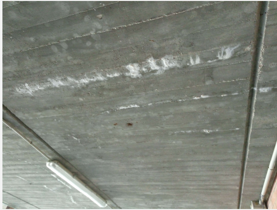
Foto 6. Eflorescència sota la coberta
