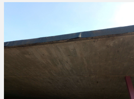
Foto 5. Làmina despegada del lateral
