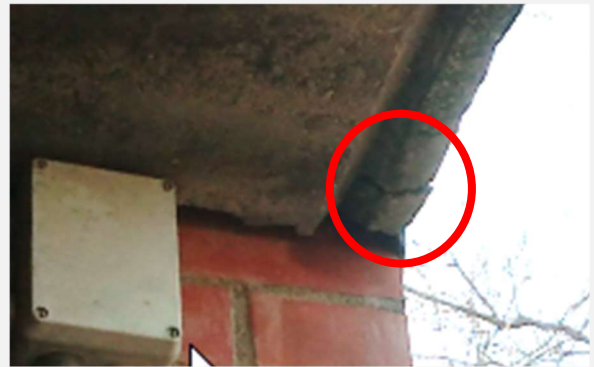
Foto 9. Desperfecte formigó a la unió coberta-edifici principal
