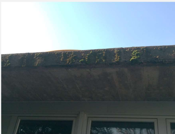
Foto 8. Aparició de molsa al lateral de la coberta
